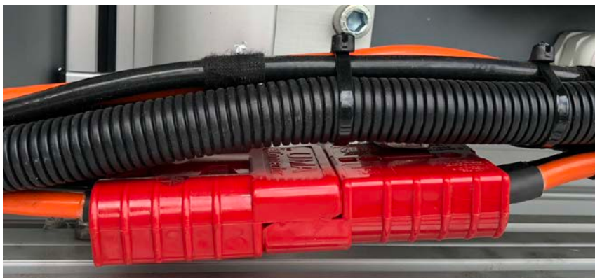
Kontaktdonen för skyltens kraftförsörjning.
